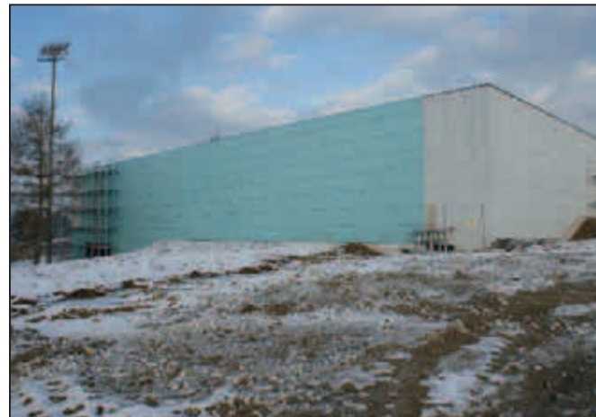
■ Suite aux actes de vandalisme, les façades vont avoir de nouvelles vitres.
