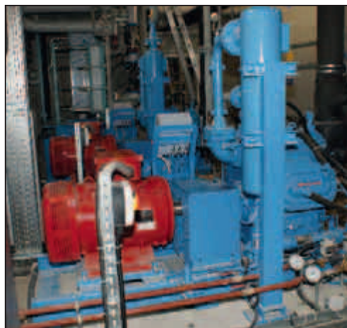
■ Les compresseurs de refroidissement.
