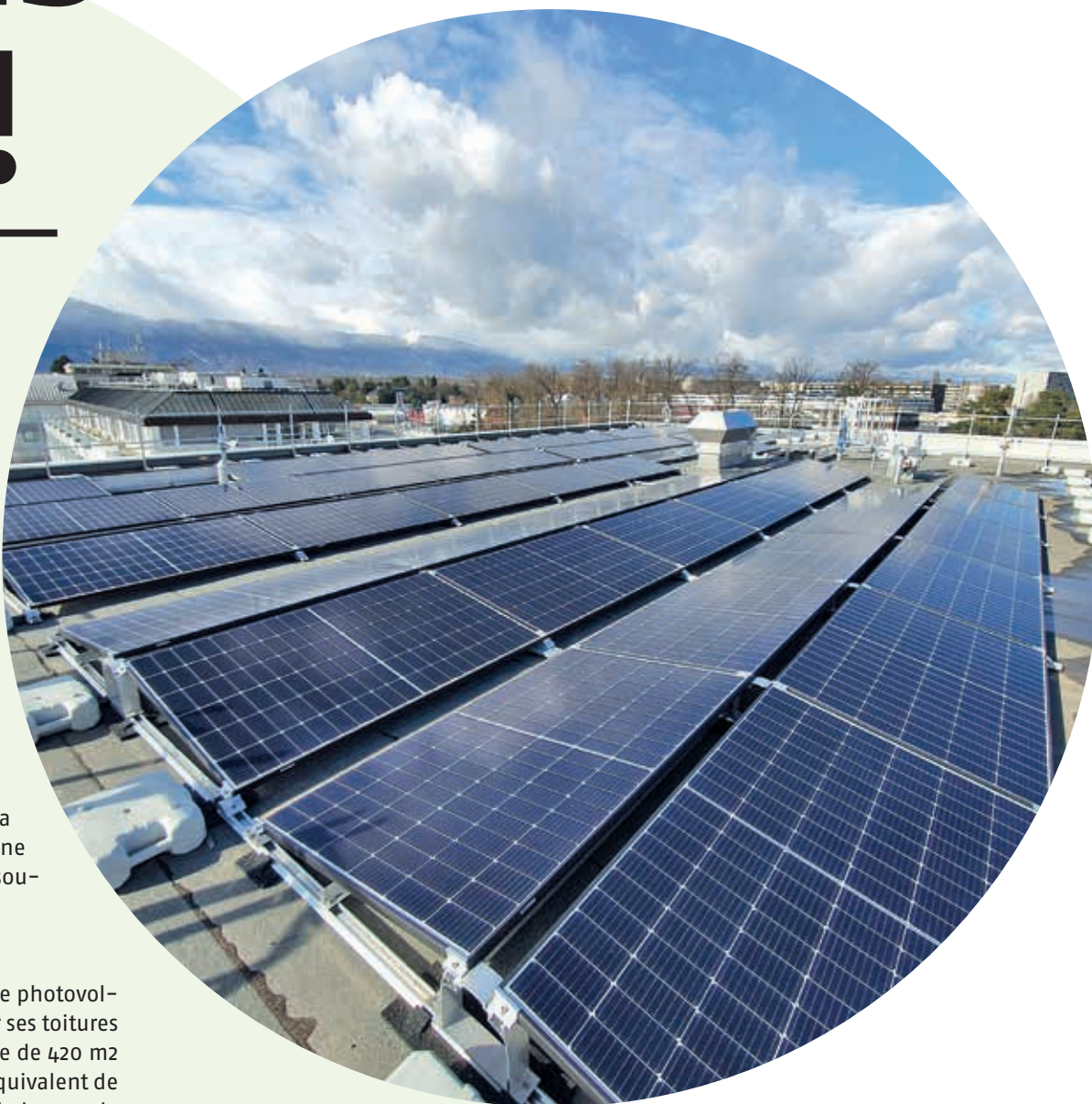
L'installation photovoltaïque de OM Pharma © Jérôme Gottaz/ OM Pharma SA
