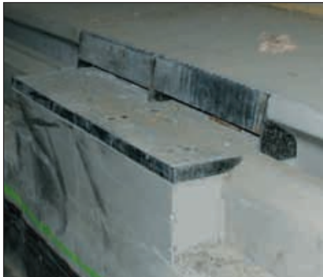
■ Des cloisons «coupe-feu» recueillent d'éventuels fuites d'essence.
