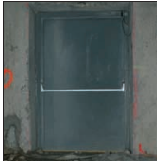
■ Des sorties de secours placées de chaque côté du tunnel.
