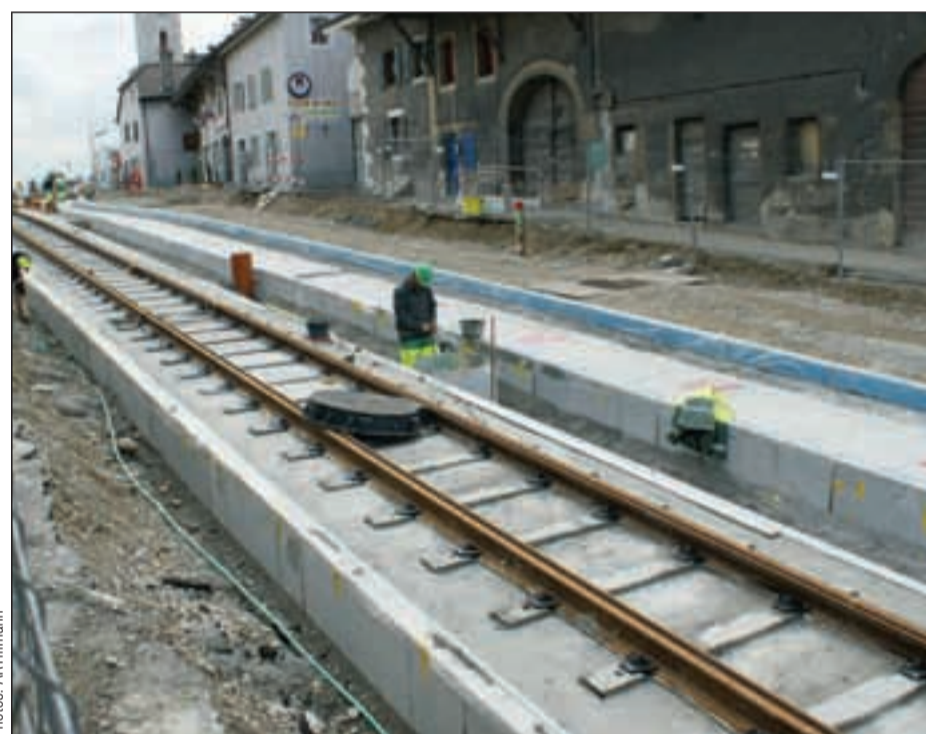
■ La pose des rails avance à grands pas sur la route à Meyrin-Village.
