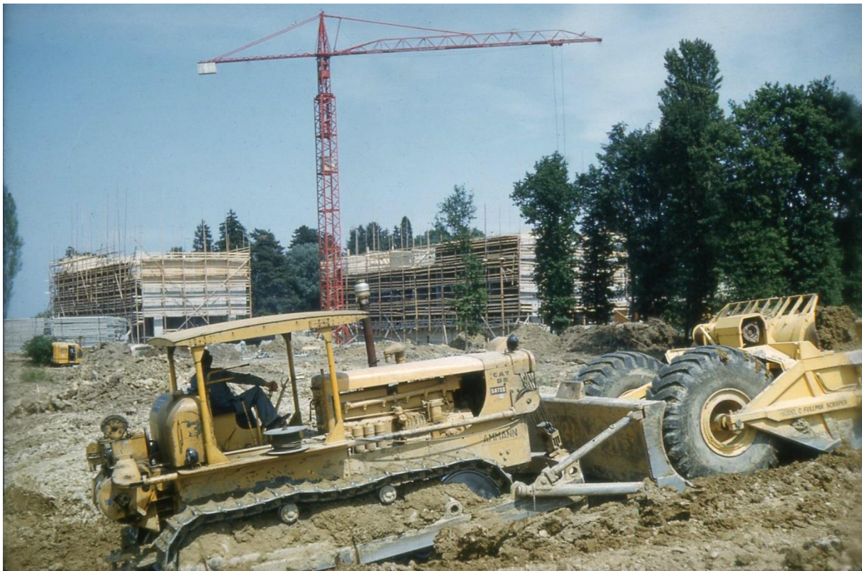
Travaux de terrassement lors de la construction de la Cité, 1960-1961. Diapositive D-RU-051, W. Rutz. ACM
