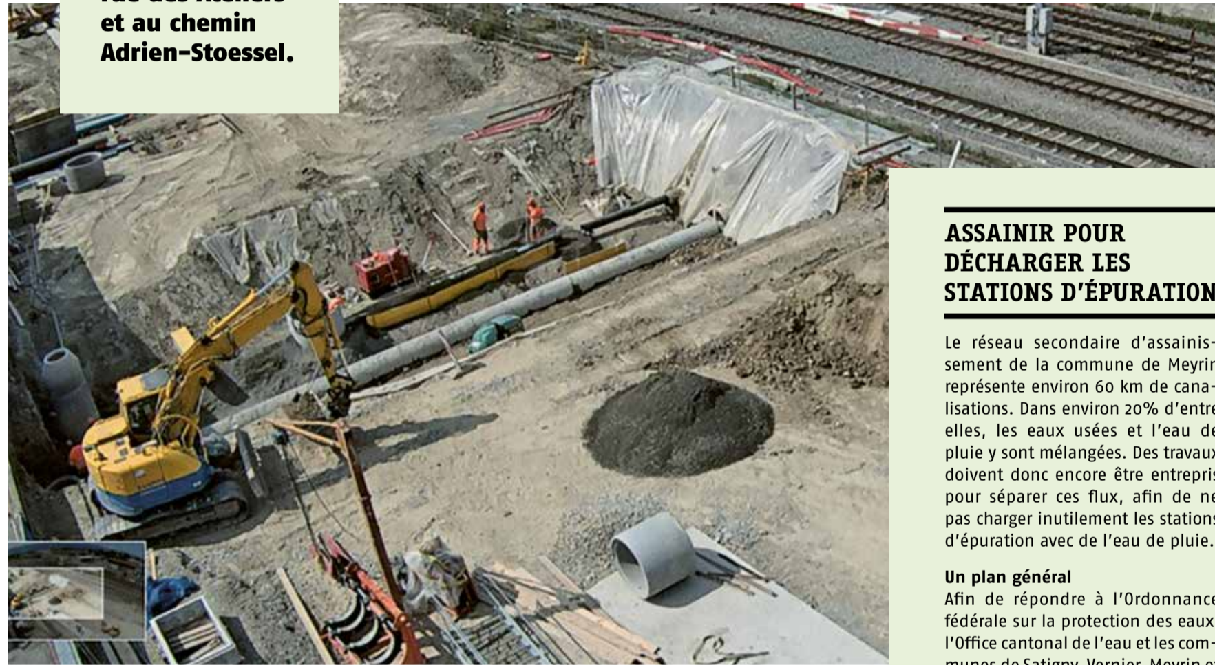
Installation de chantier de la cellule de poussée pour le passage sous voie des canalisations
